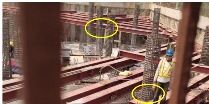
Gambar 2. Strutting yang menghambat kolom
