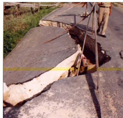
Gambar 2. Kerusakan jalan di atas tanah gambut (Sumber : Yulianto, 2017)
