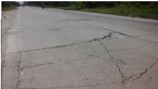
Gambar 3. Rigid badan jalan retak di Kabupaten Pelalawan
