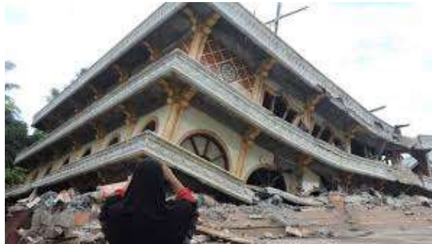
Gambar 1. Bangunan roboh karena gempa
