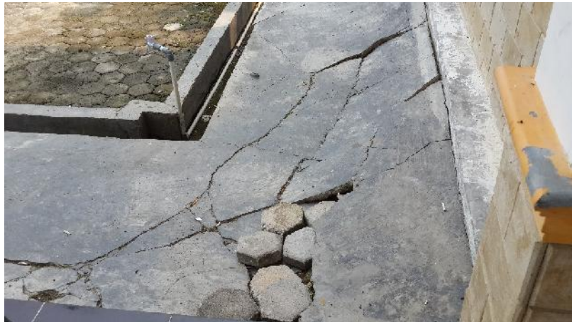
Gambar 2. Kondisi penurunan lantai
