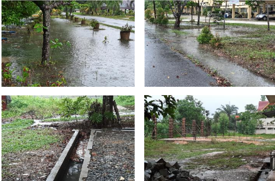
Gambar 2. Kondisi Eksisting Drainase Fakultas Teknik
