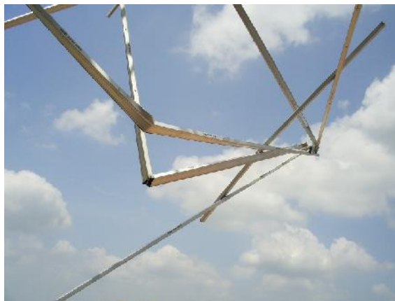
Gambar 4. Pengamatan Keruntuhan pada Joint 2
