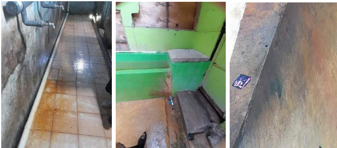
Gambar 7. Bercak Warna Kuning Kemerahan Pada Kamar Mandi Panti Asuhan yang Mengikuti Pola Aliran Air Akibat Kadar Besi (Fe) Dan Mangan (Mn) Dalam Air Sumur
