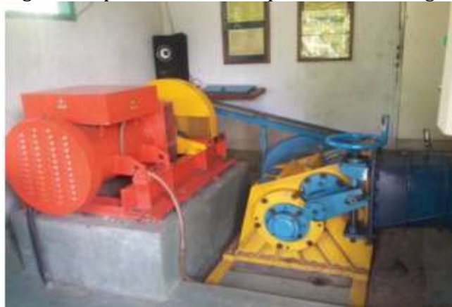
Gambar1. Generator dan Turbin Pembangkit Seloliman
