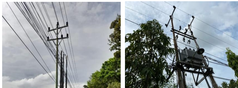
Gambar 4 . Jaringan Listrik (Sumber: Data Pribad, 2025i)
