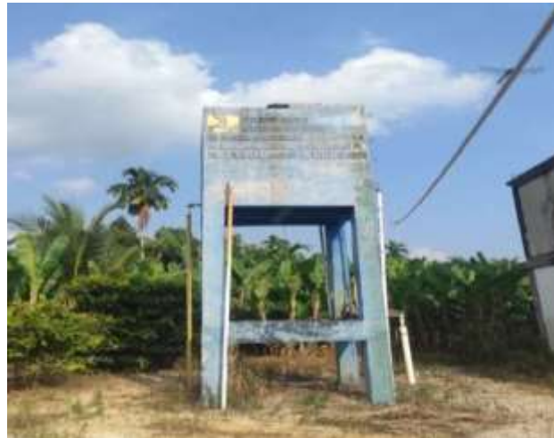
Gambar 3. Bak Penampungan Air di Desa Kampung Pinang
