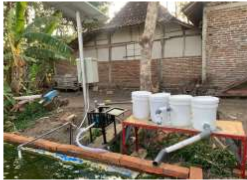
Gambar 2. Pengimplementasian alat Pompa Air Tenaga Surya dan Pemantauan pH dan Suhu.
