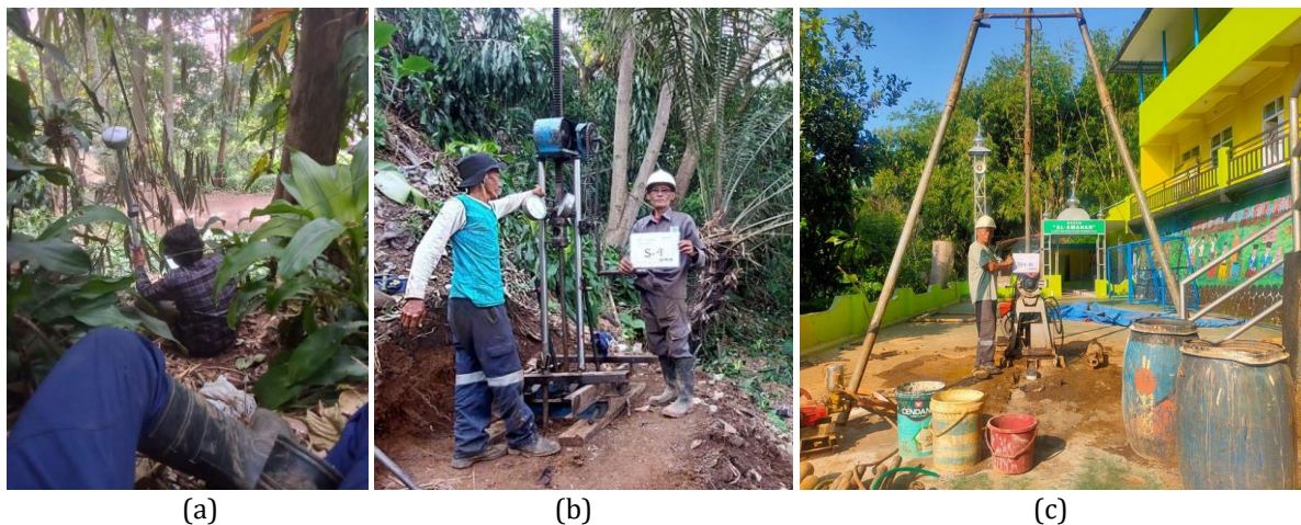
Gambar 2. Pelaksanaan (a) topografi menggunakan metode RTK, (b) uji sondir, dan (c) uji bor-SPT
