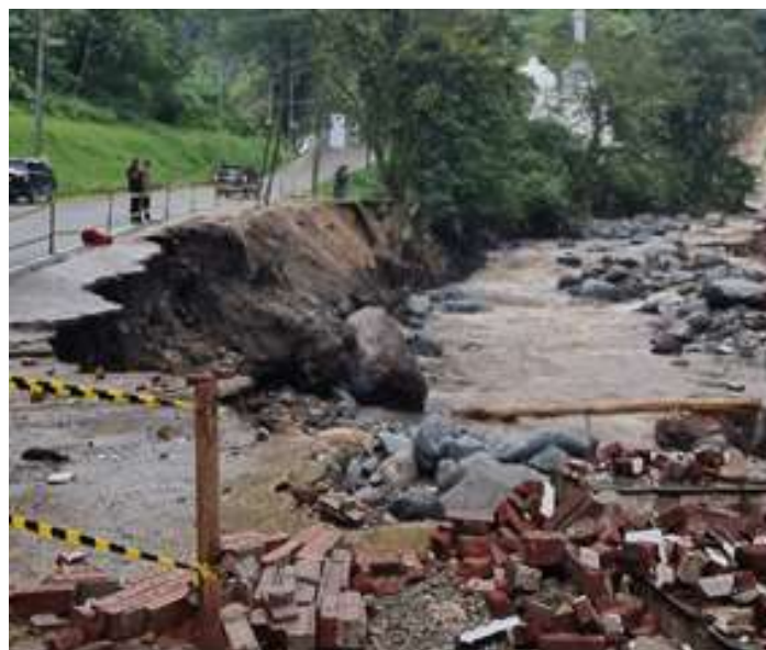
Gambar 6. Kondisi tebing dengan bahu jalan sejauh 1 meter
