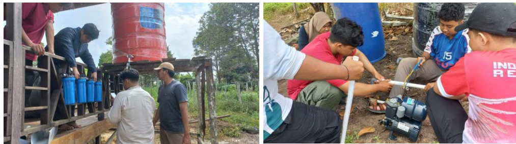
Gambar 5. Instalasi Rainwater Harvesting (RWH) instalasi filter air (kiri), pompa air (kanan) dan jalur irigasi
