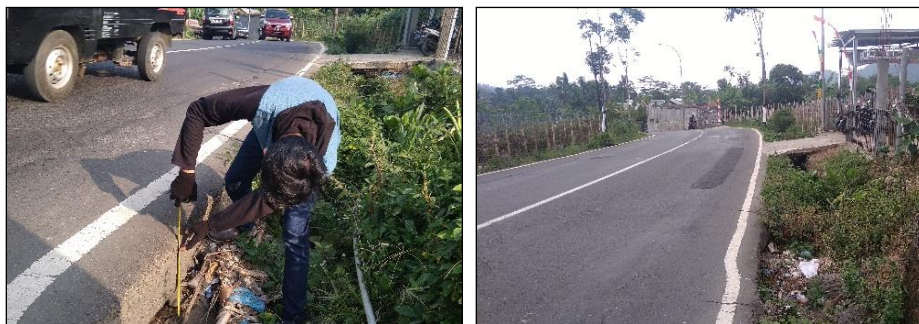
Gambar 1. Beda elevasi bahu jalan dan tepi perkerasan jalan raya turut Desa Tlahab [26]
