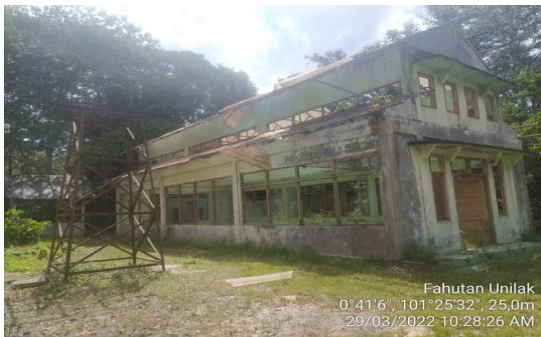
Gambar 4. Gedung yang rusak di Nursery
