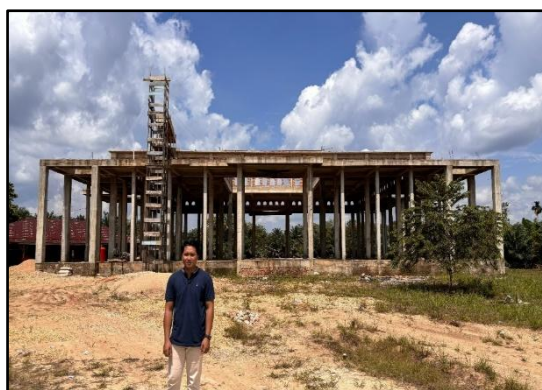
Gambar 1 Pembangunan Masjid di Desa Sorek II yang Terbengkalai
